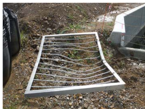
大雨時のスクリーン破損状況
