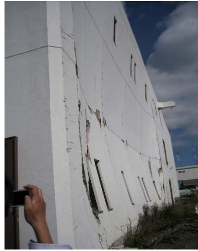
津波の直撃を受けたポンプ室外壁
